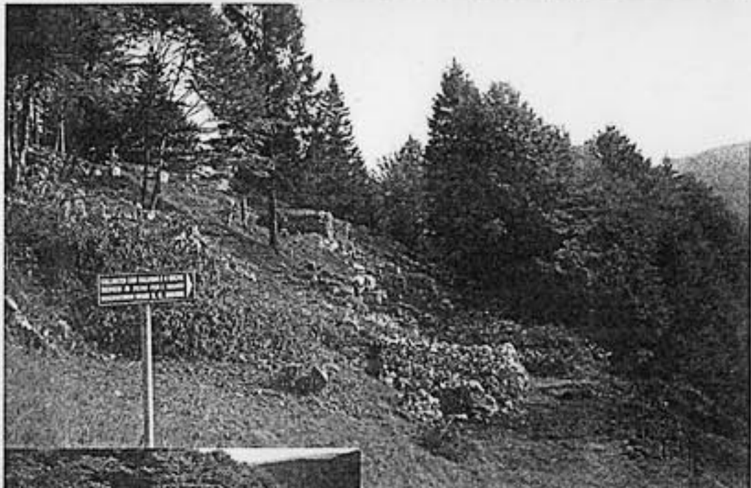
Il servizio fotografico di Benvenuto Migliavacca ci mostra la boscaglia all'inizio dei lavori e le opere che emergono dopo il disboscamento sotto la guida della Forestale
